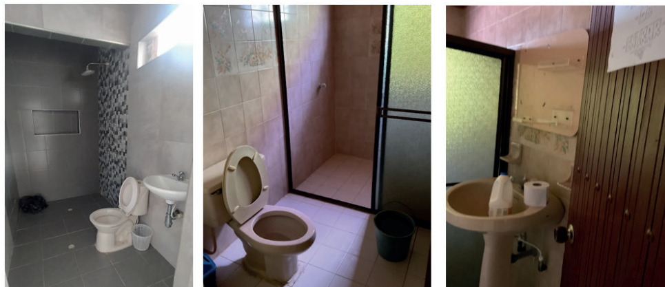
Primera imagen baño remodelado de Carmen de Bolívar. Segunda y tercera imagen baño sin acceso a agua ni adecuaciones necesarias de San Juan de Nepomuceno
